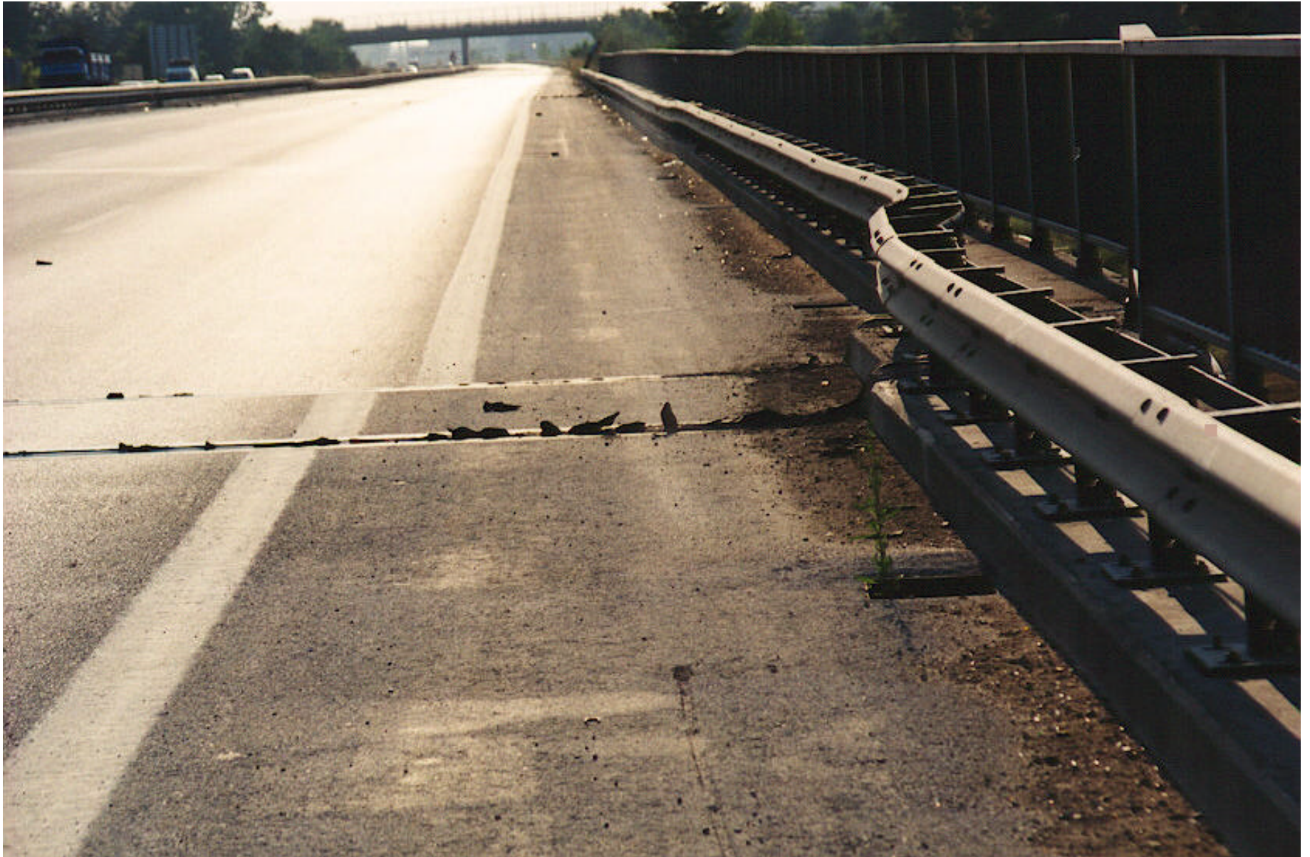
Sakarya Viaduct, 1999 Kocaeli Eq. (KOERI)
